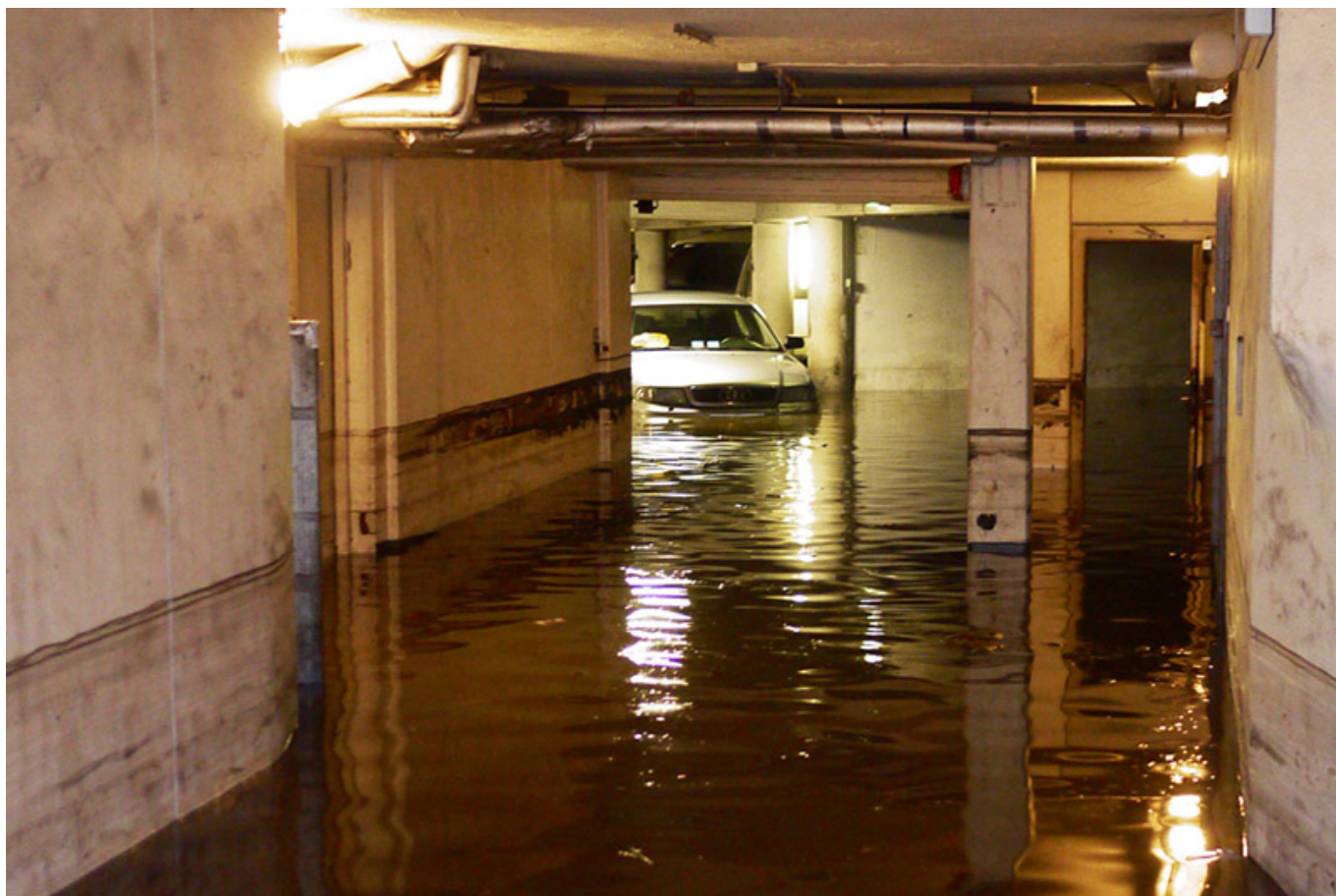
I samband med det stora skyfallet i Malmö hösten 2014 var det många som drabbades av översvämningar och vattenfyllda källarutrymmen. Foto: Daniel Skog
